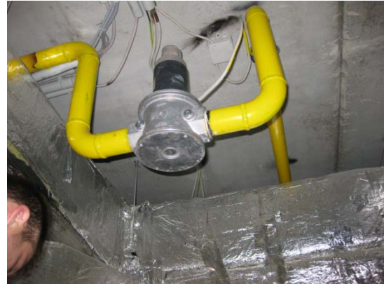
Bild 4 Gasleitung im Keller 03, Magnetventil für Lehrküche „A“
