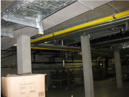
Bild 3 Gasleitung im Keller 09.
