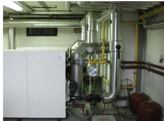
Bild 16 Zentralheizungskessel Quadron 3 R 2905
