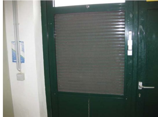
Bild 24 Verschließbare Lüftungsöffnung in der Tür des Heizraumes
