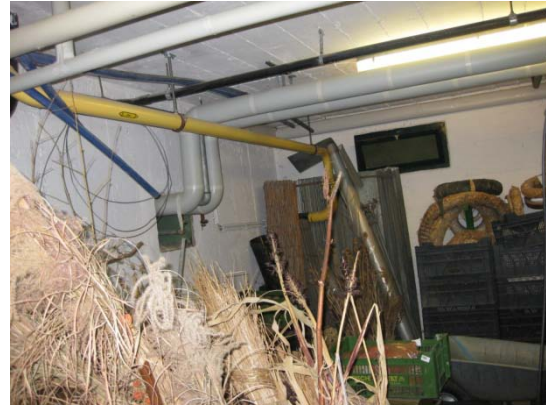
Bild 28 Rohrverlauf im Keller
