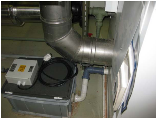
Bild 9 Abgasleitung des kleinen Kessels
