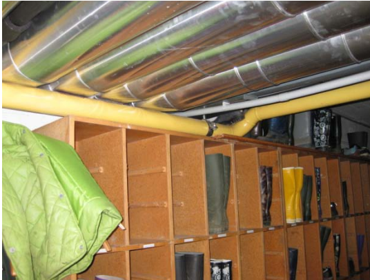
Bild 27 Rohrverlauf im Keller
