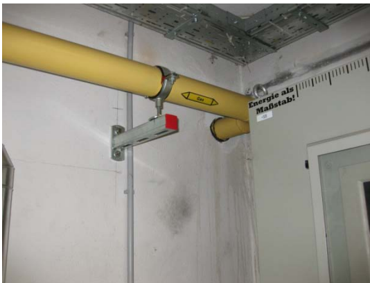
Bild 19 Hauptleitung im Heizraum
