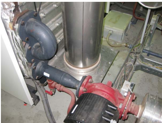
Bild 21 Abgasleitung des kleineren Kessels
