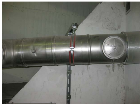
Bild 12 Abgasleitung des großen Kessels
