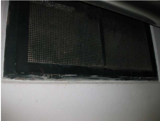
Bild 23 Nicht verschließbare Lüftungsöffnung
