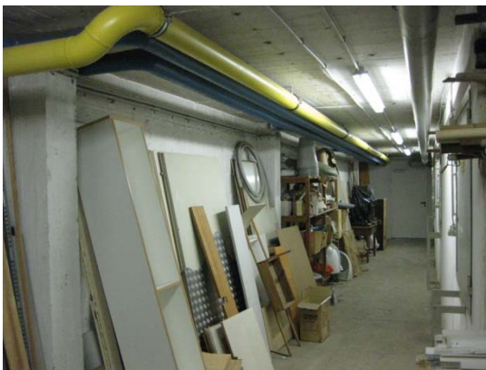
Bild 5 Gasleitungsführung im Gang
