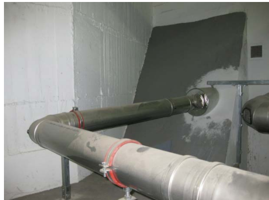
Bild 10 Abgasleitung des kleinen Kessels
