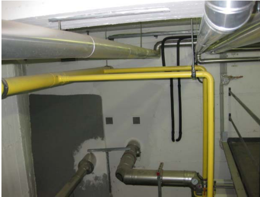
Bild 7 Gasleitungsführung im Heizraum
