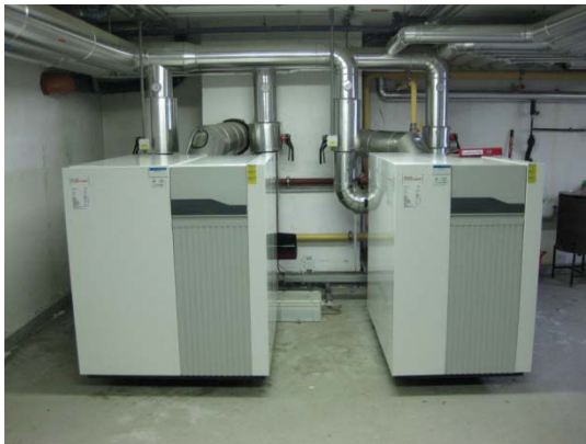
Bild 15 Zentralheizungskessel Quadron 3 R 2908
