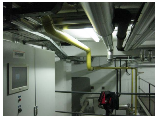
Bild 6 Gasleitungsführung im Heizraum
