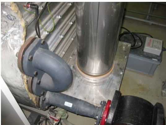
Bild 11 Abgasleitung des großen Kessels
