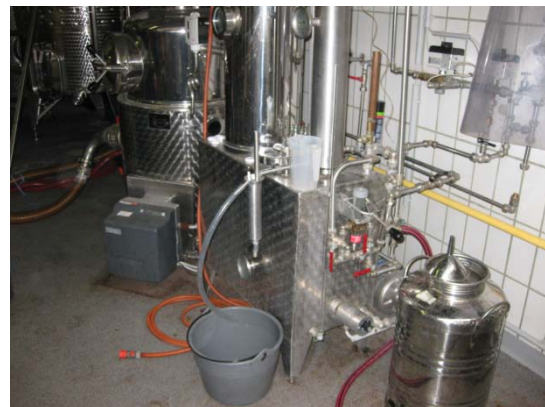
Bild 26 Schnapsbrennkessel mit Gasbrenner
