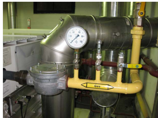
Bild 22 Abgasleitung des kleineren Kessels
