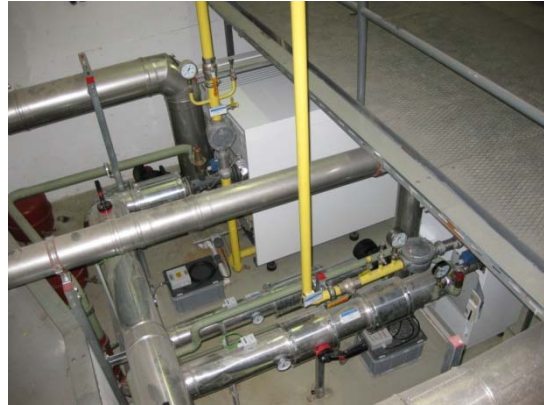
Bild 8 Gasleitungsführung im Heizraum
