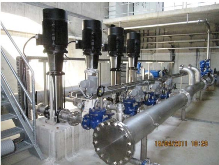
Pumpwerk Raaba; Quelle: LRH
