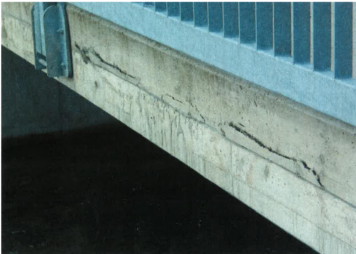
Abb. 18: Betonabplattungen beim Brückentragwerk Quelle: Unterlagen der BBL BM
