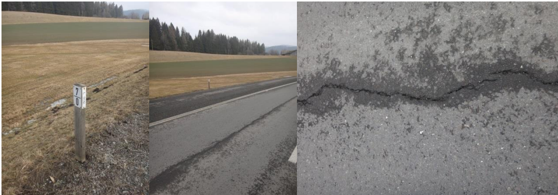
Abb.: Längsriss an der L 502 bei km 7,0
