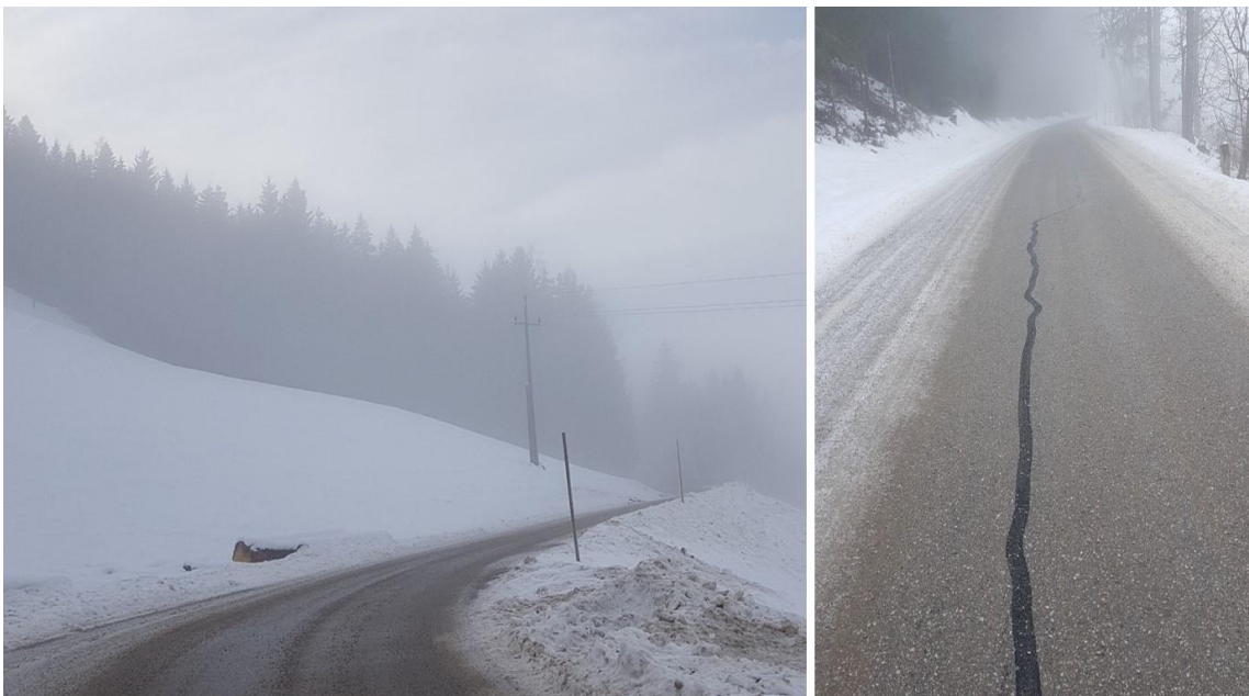
Abb.: Verlauf des sanierten Oberhausbergweges ca. 1.650 m nach Projektanfang (links) und vergossene Längsrisse ein paar Jahre nach der Sanierung im weiteren Wegverlauf zeigen die Wichtigkeit einer laufenden Instandhaltung zum Substanzerhalt durch die jeweilige Gemeinde (rechts)
