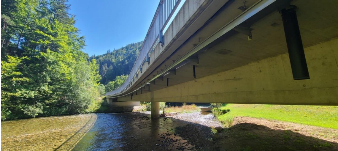
Abb.: Kaiser-Josef-Brücke über die Mürz mit dem mittig angeordneten Flusspfeiler: Blick (flussabwärts) unter dem kurveninnenseitigen Randbalken; punktuelle Betonsanierungen am Spannbetonhohlkasten mit Kragplatten; erneuerte Abläufe unter der Kragplatte
