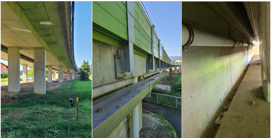
Abb.: links: Blick (Fahrtrichtung Deutschlandsberg) entlang des Sickerkörpers unter der Brücke entlang der Abtropfbleche; Mitte: Entwässerungsrinne entlang des Abtropfbleches im Bereich des abgesenkten Gehweges sowie wiederverwendete Aluminiemelemente als Lärmschutzwand am neuen Geländer (Blick in Fahrtrichtung Deutschlandsberg) rechts: Blick quer unter der Fahrbahn in den neu errichteten Inspektionsgang bei der Auflagerbank zwischen Schottermauer (links) und Brückentragwerk (rechts)
