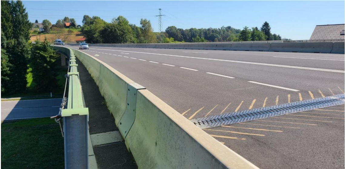
Abb.: B 76 Radpass Straße auf der Gamsbachbrücke (Blick in Fahrtrichtung Graz): neues Fahrzeugrückhaltesystem mittels Betonleitwänden (vorher: Leitschienen), erneuerter Fahrbahnübergang (Fingerfugen) und verstärkter angrenzender Asphaltbelag (schräge Rippen)
