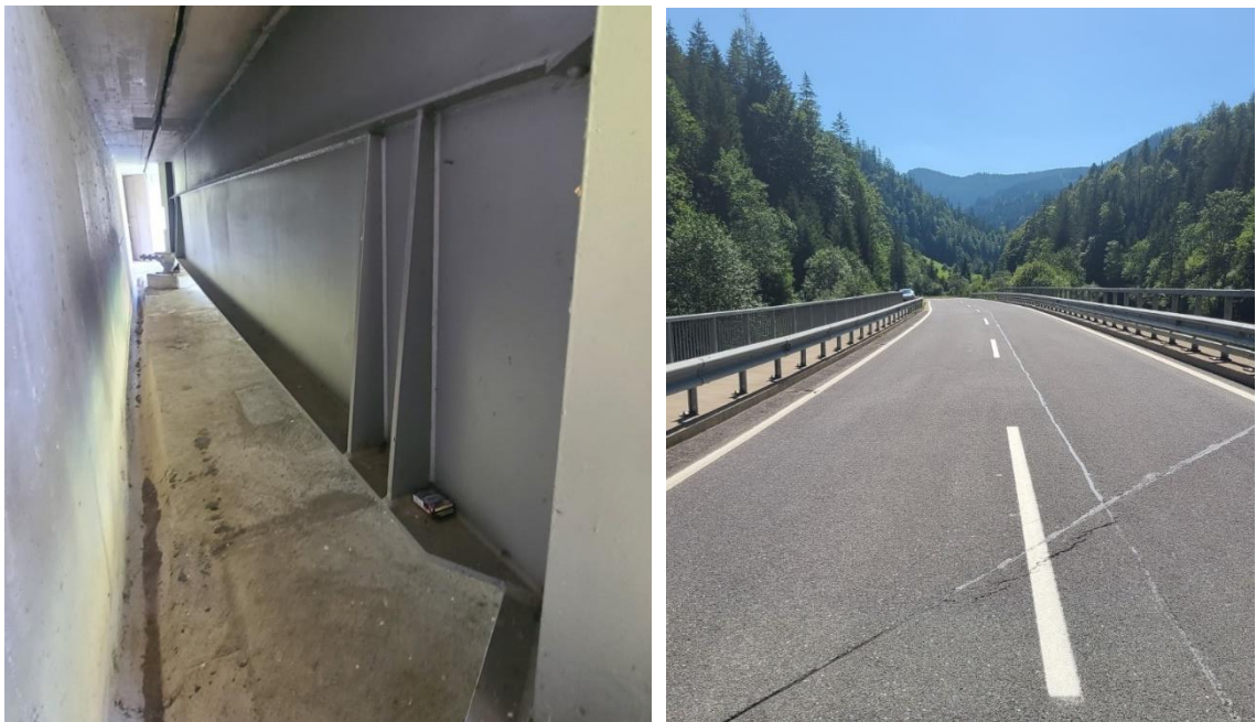
Abb.: links: Blick quer unter der Fahrbahn in den neu errichteten Inspektionsgang bei der erhöhten Auflagerbank zwischen Schottermauer (links) und verstärktem Stahlquerträger des Brückentragwerks (rechts)
