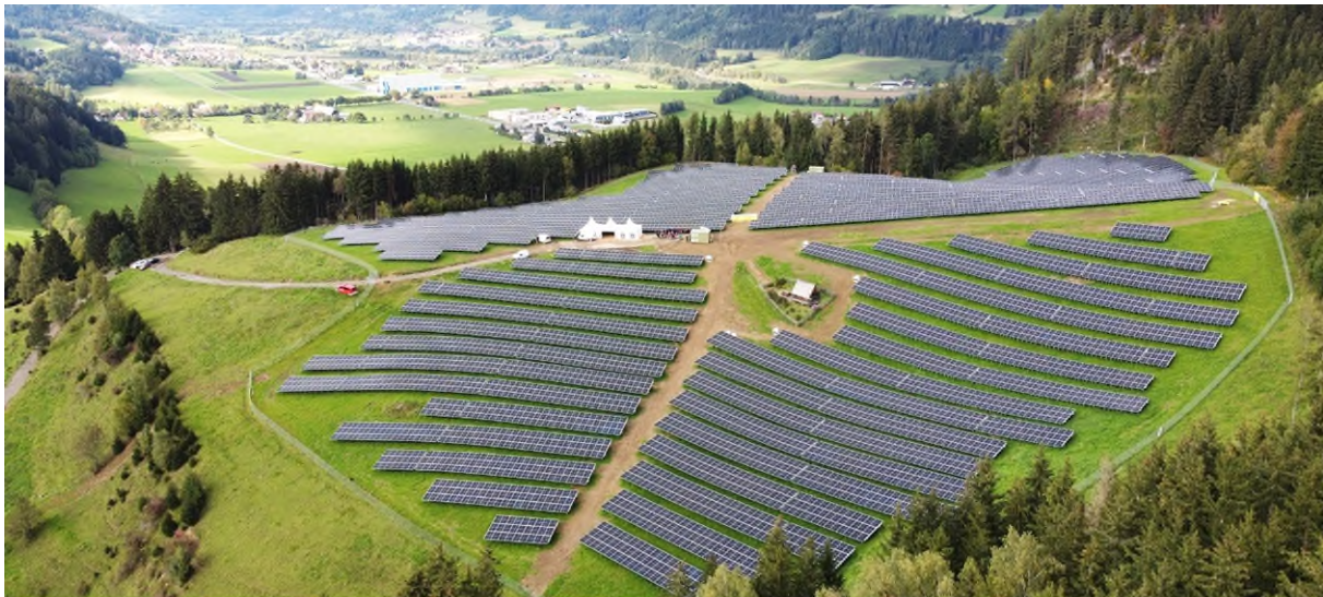
Abbildung: Photovoltaik-Freiflächenanlage Feistritzgraben
